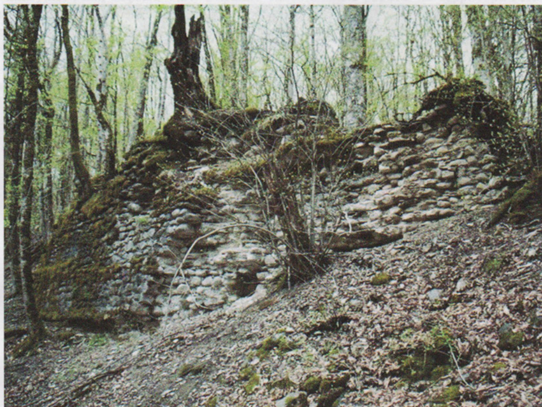
Рис. 4. Лучше всего стены Ачипсинской крепости сохранились в северной части крепости и в юго-восточном углу, где высота стен достигает 5 м.
